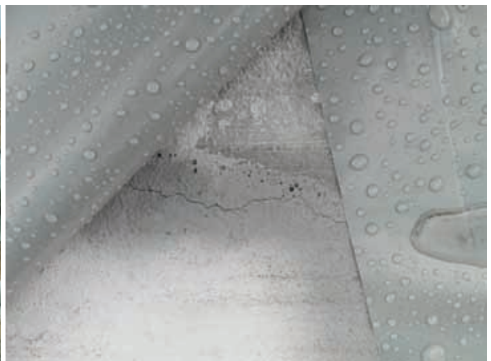
Bild 9 Riss an der Betonoberfläche durch unzureichende Nachbehandlung
