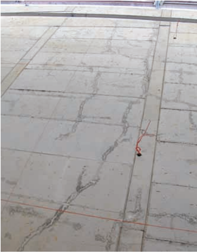
Bild 3 Risse mit Aussinterungen an der Decke
