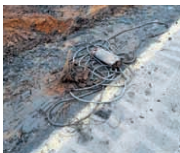
Fund eines alten Elektrokabels und Müll (T6)
