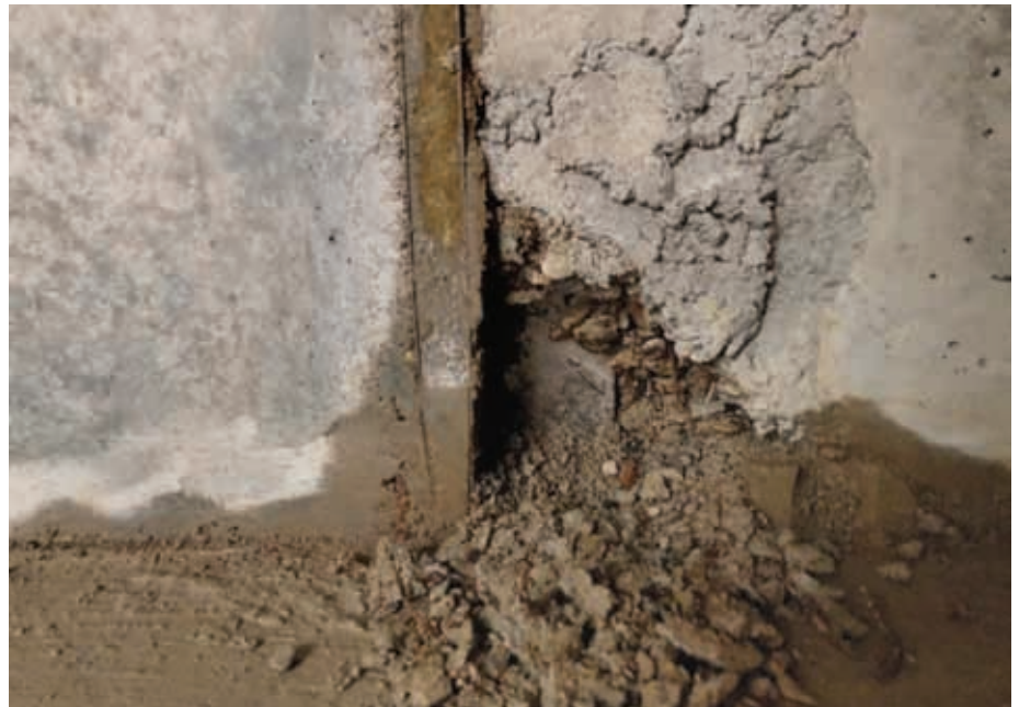
Bild 6 Sichtbare Fehlstellen bei einer WU – Konstruktion
